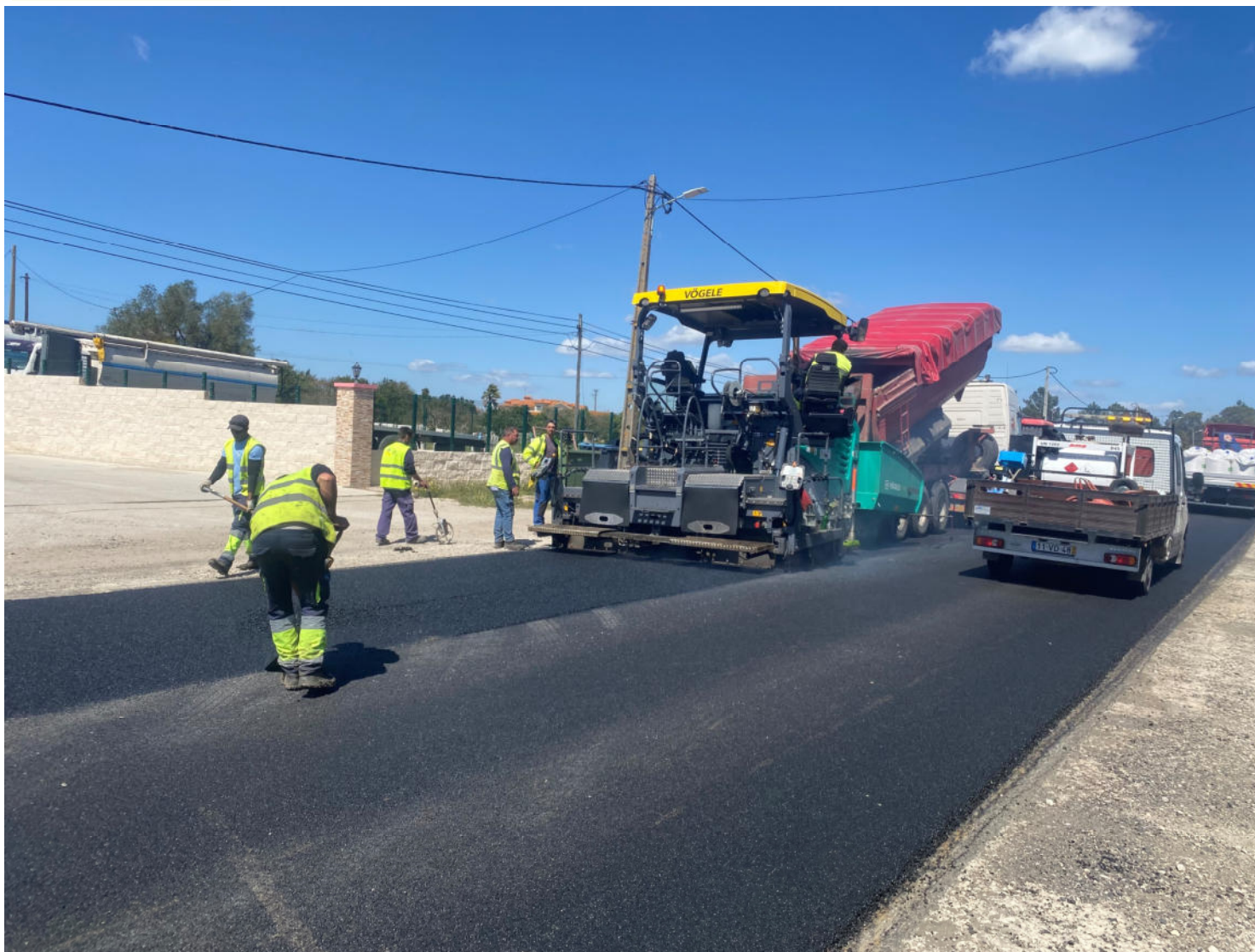
Operação em Pavimentação de Camadas Betuminosas com Borracha Reagida e Ativada (RAR)
