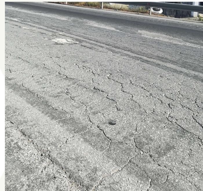
3 – Troço adjacente sem BB
