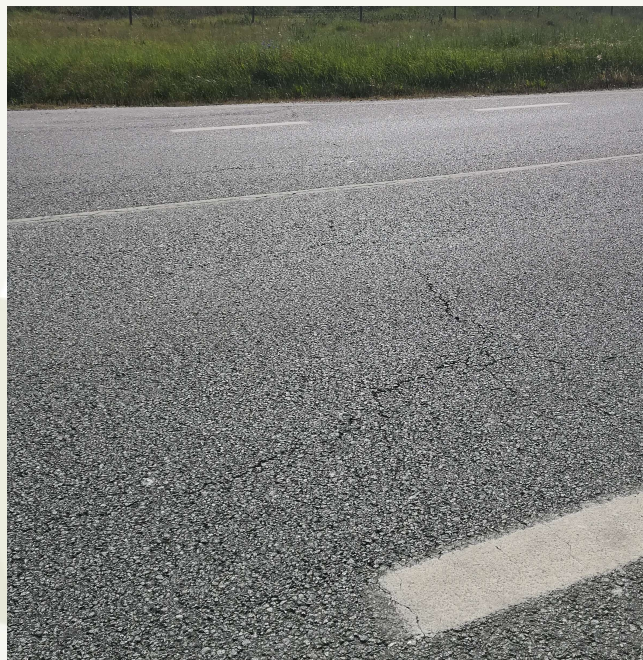
2 – Degradação mais comum
